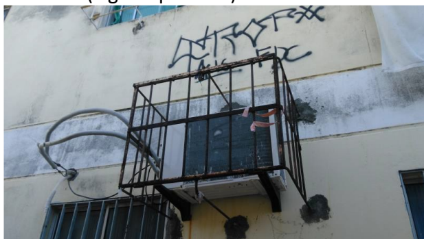
Figura 3: Instalação de condicionadores de ar com a perfuração de elementos estruturais (vigas e paredes) na fachada.
