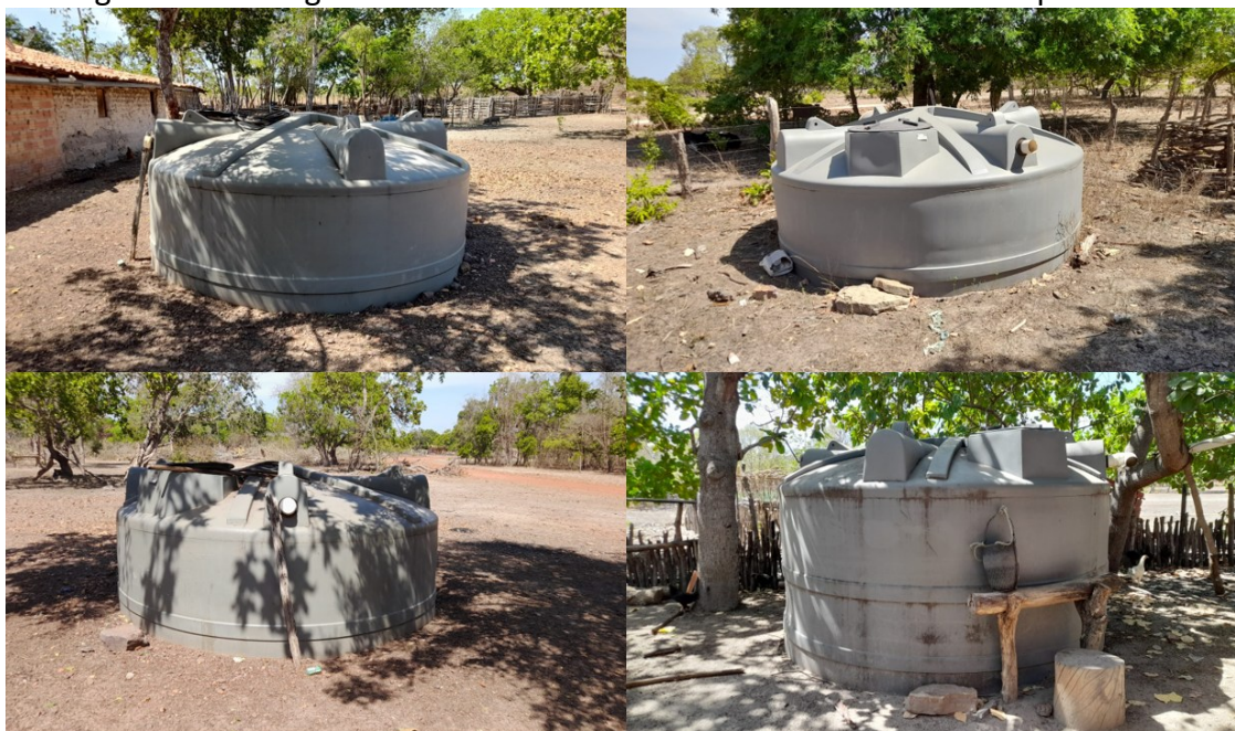
Figura 3 – Visão geral de cisternas instaladas em área do semiárido piauiense.
