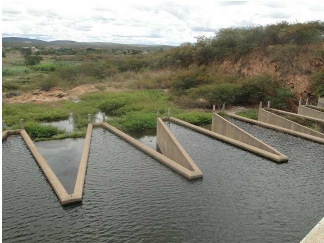
Figura 8 – Vertedouro do Açude Ubaldinho
