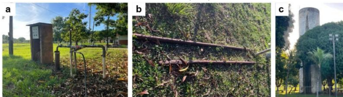
Figura 3 – Poço 1 em campus universitário de Teresina (PI): (a) poço tubular com bomba; (b) tubulações de distribuição; (c) caixa d'água para armazenamento Fonte: Autores (2025).
