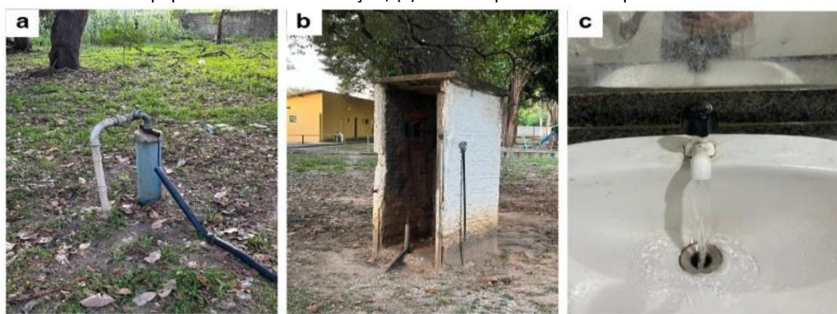
Figura 4 – Poço 2 em campus universitário de Teresina (PI): (a) poço tubular; (b) abrigo de equipamentos de distribuição; (c) torneira próxima usada para coleta Fonte: Autores (2025).
