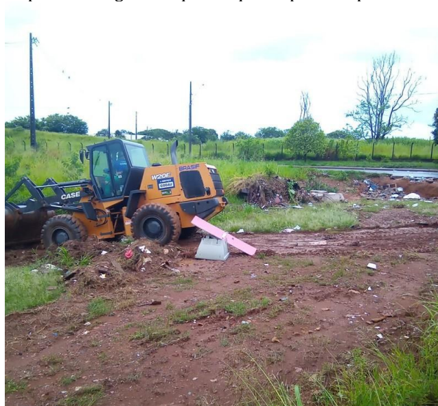
Figura 5 – Limpeza de pontos irregular reque máquinas pesadas para a eficiência dos trabalhos.
