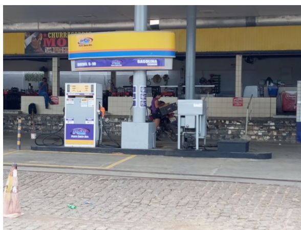
Figura 3. Ilha de abastecimento (bomba de diesel) do Posto Santa Rita.
