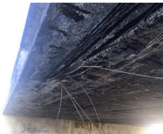
Figura 4: Rompimento de cabo de protensão da viga longitudinal leste
