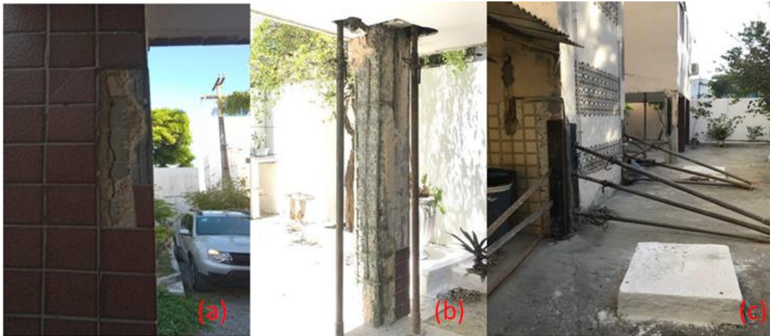
Figura 3 - Pilar com deslocamento e fissuras paralelas à armadura (a); Recuperação de pilar (b); Recuperação de pilar (c)
