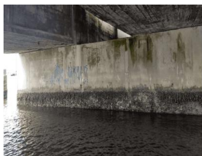
Figura 7 - Presença de eflorescência e corrosão
