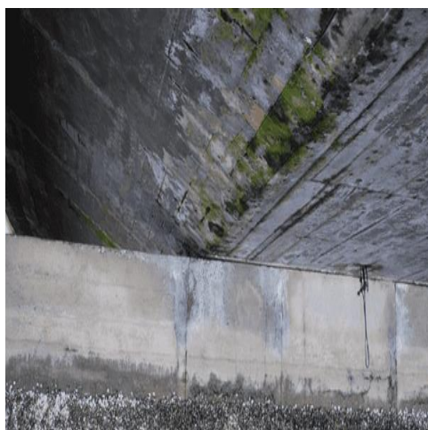
Figura 3a - Eflorescência e presença de agentes biológicos
