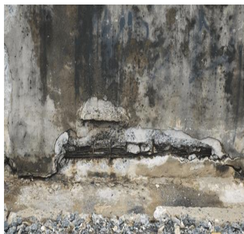
Figura 3b - Exposição da armadura da viga longitudinal
